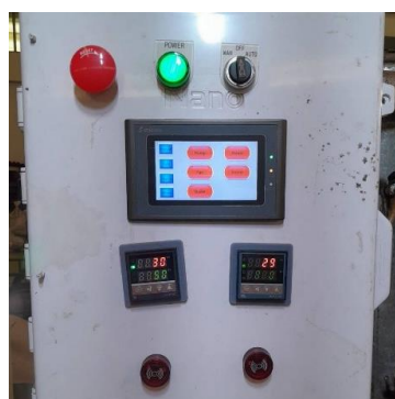
ภาพที่ 3. ระบบควบคุมไฟฟ้าด้วย PLC
