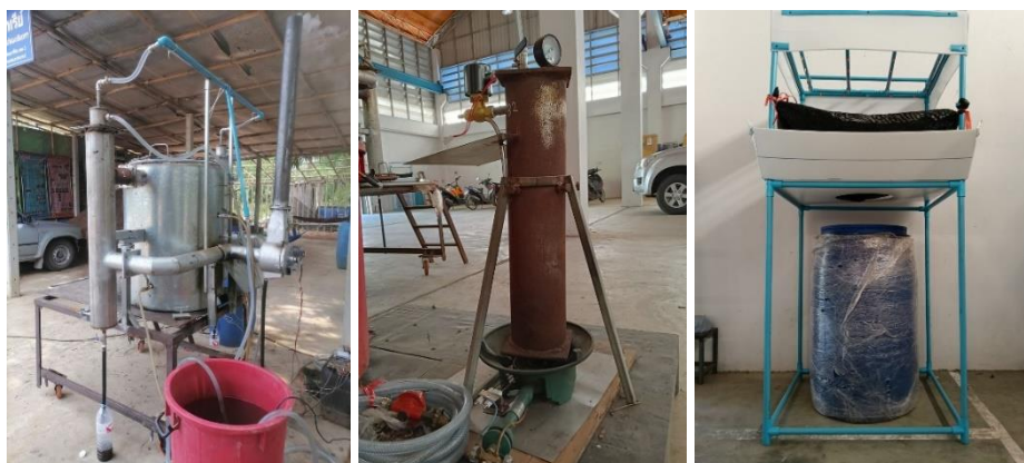
ภาพที่ 2. เตาต้นแบบใหม่ Boiler และ Cooling Tower
